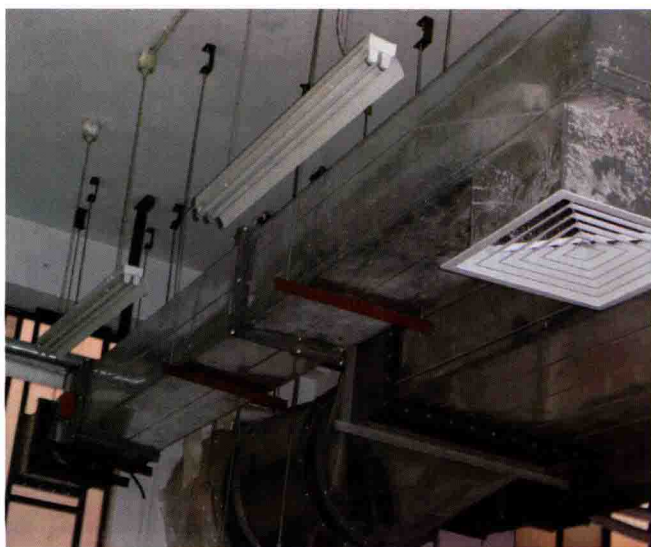
图 10-52 空调送风系统
