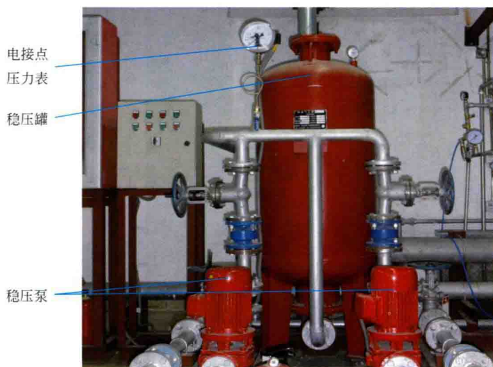
图 10-37 消防增压稳压设备
