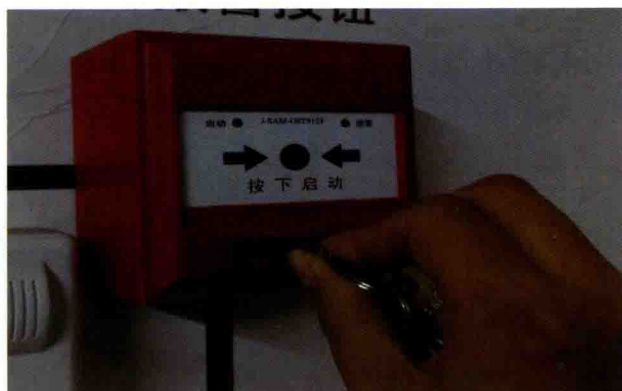
图 10-10 对消火栓按钮复位
