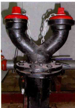
(b) 地下式水泵接合器
