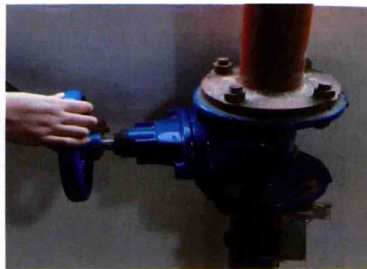
图10-15 关闭消防炮入口阀门
