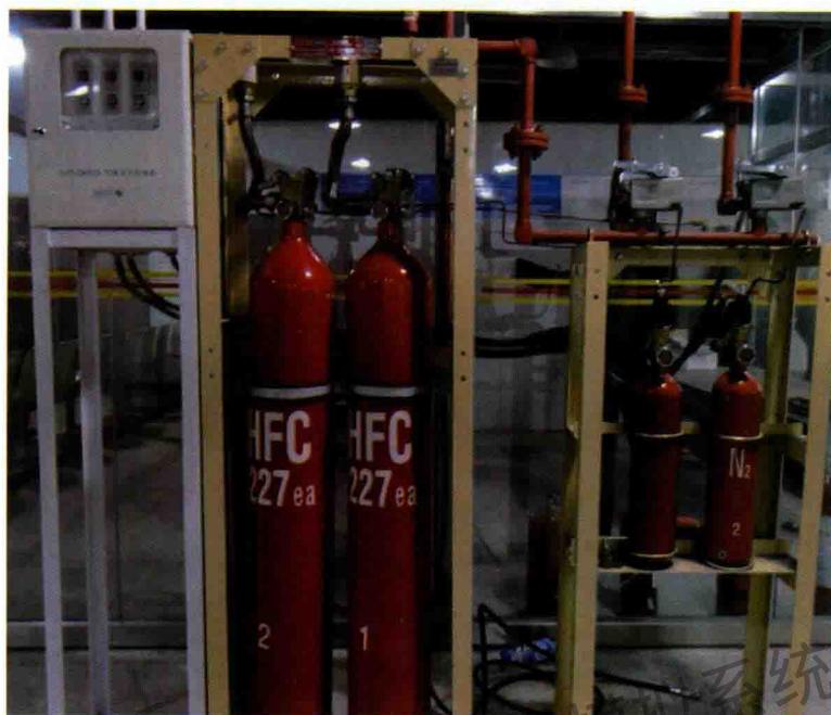
图 10-44 七氟丙烷灭火系统
